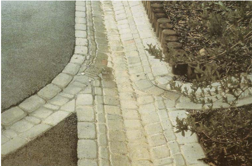
Beispiel einer Entwässerungsrinne
